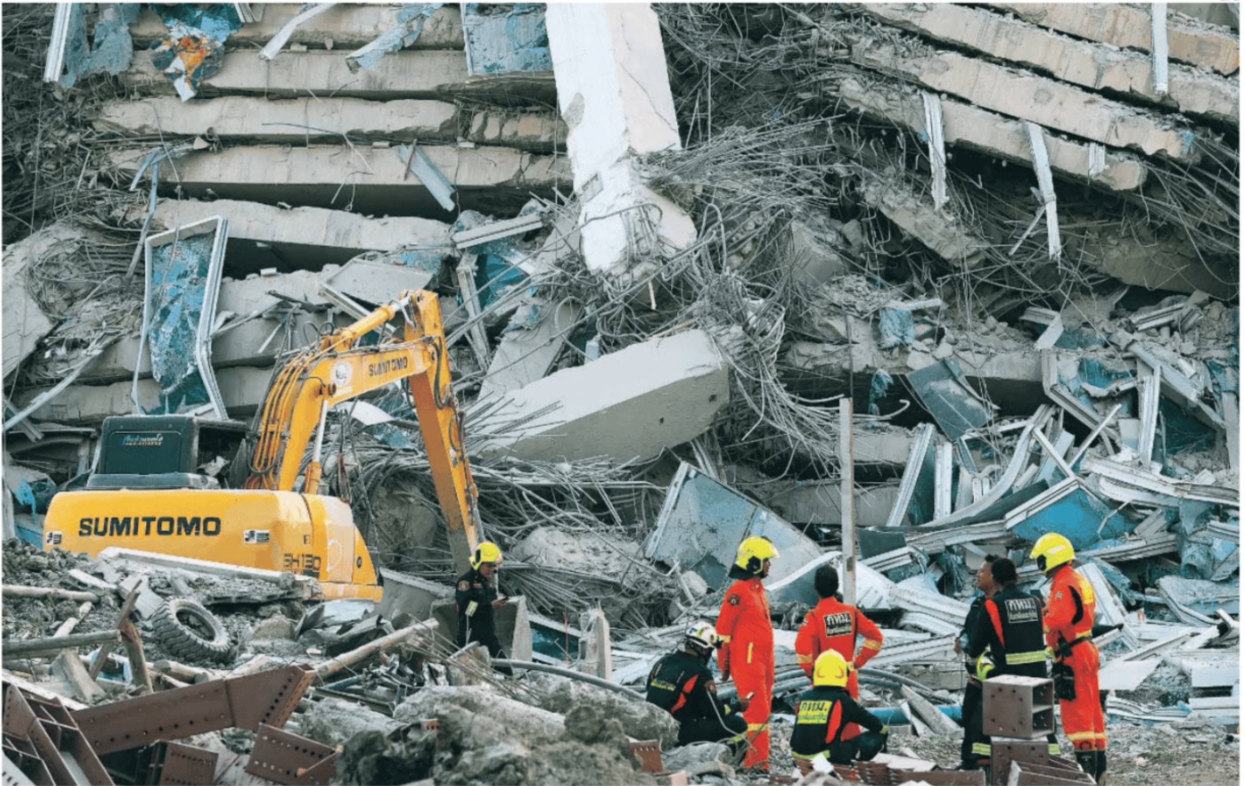
Rescatadores trabajan entre los escombros de un edificio que colapsó en Bangkok
