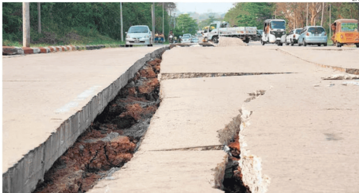
Grietas en una carretera de Birmania tras el seísmo
